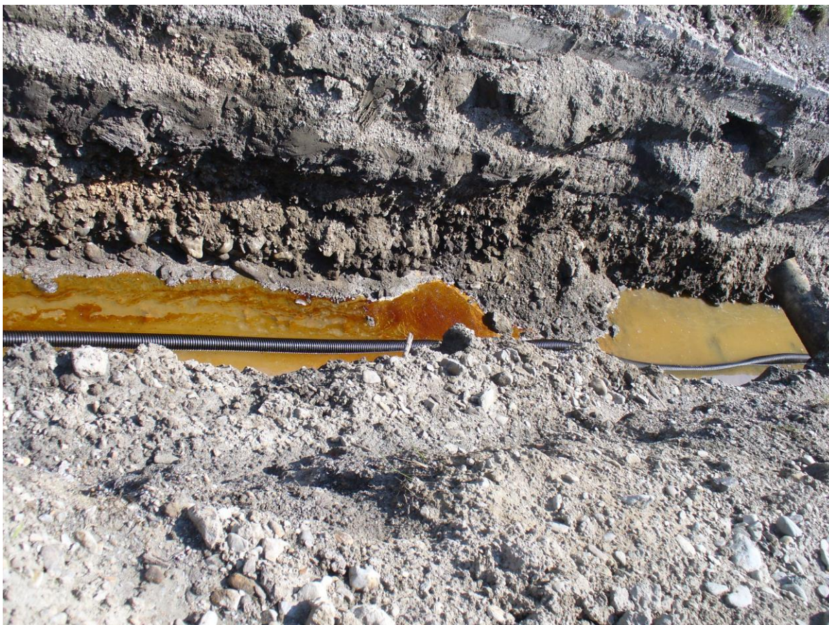
Obr. č. 11 a 12 Sanačný drén na čerpanie podzemnej vody s voľnou fázou ropných látok
