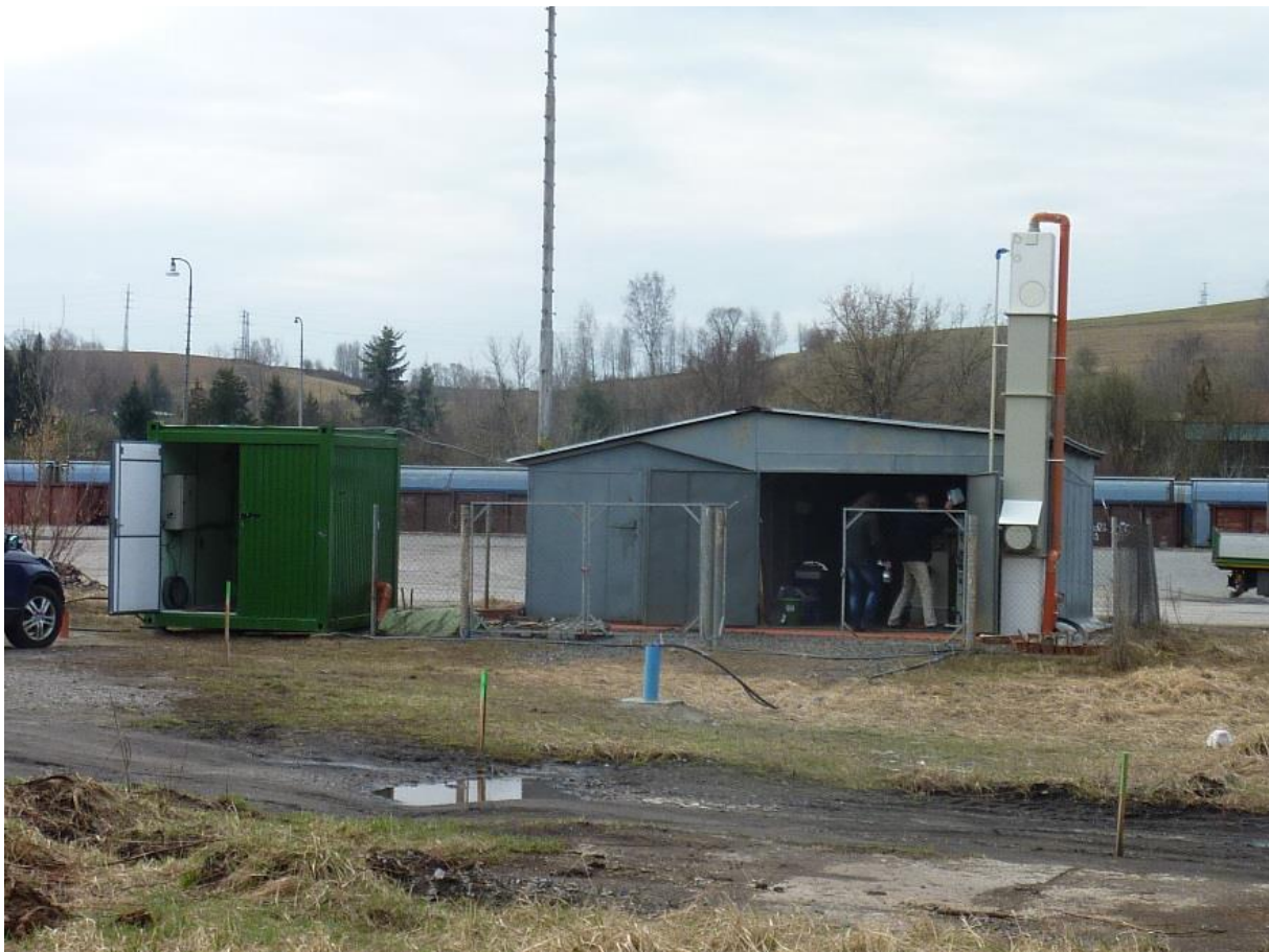
Obr. č. 7, 8 a 9 Technologické zariadenie na čistenie čerpanej podzemnej vody (Zdroj: MŽP SR)
