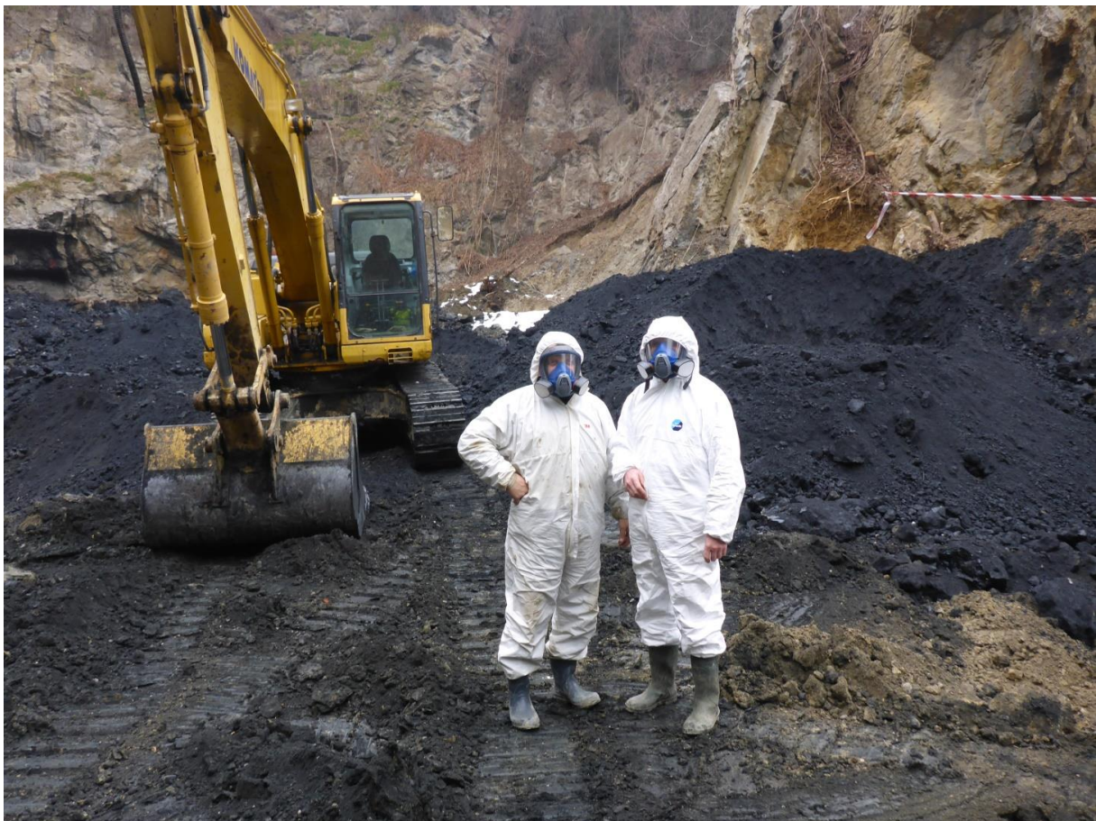
Obr. č. 6 Počas sanácie environmentálnej záťaž sa analyzovali a zohľadňovali aj zdravotné a hygienické podmienky prác.
