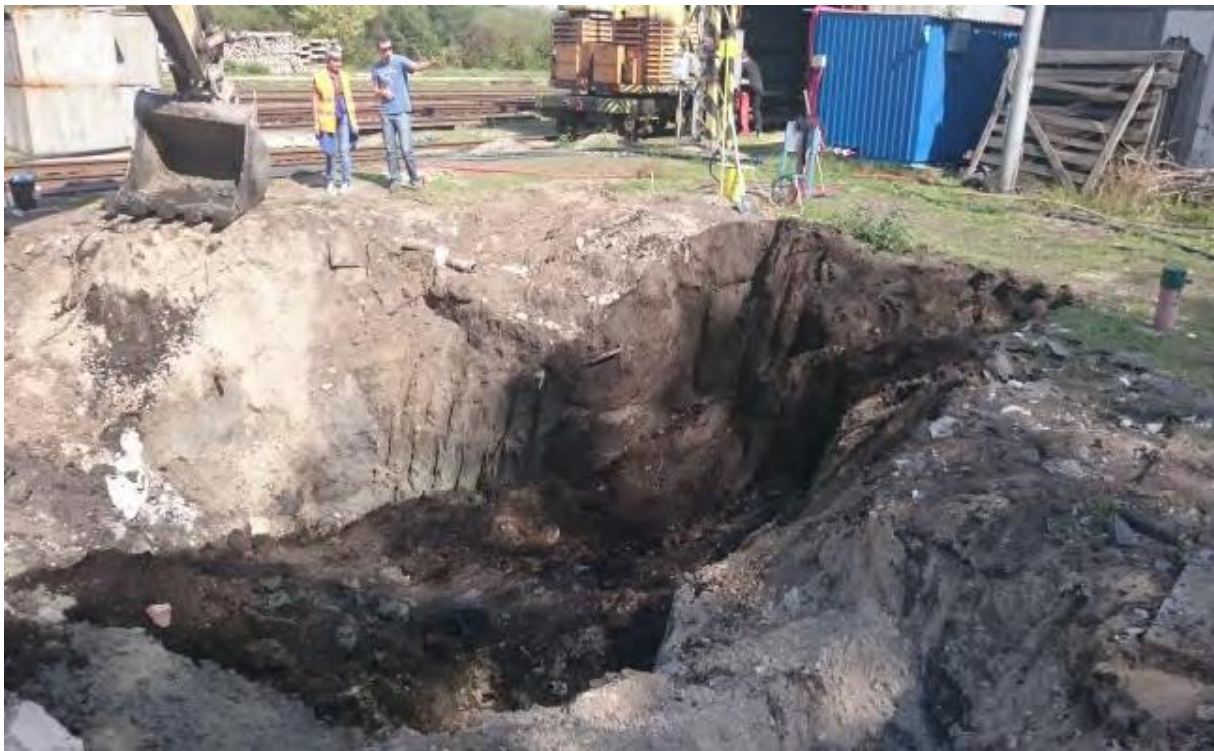
Obr. č. 16 Odťažba kontaminovaných zemín, na zábere sú viditeľné tmavo sfarbené kontaminované zeminy priamo spod zdroja znečistenia lokality – dvoch podzemných nádrží.
