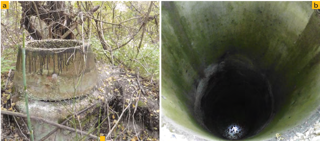
7 Betónová šachta v oblasti lužných lesov (a) a pohľad do jej útrobov (b), je vidieť značne poškodený stav predovšetkým na spoji betónových skruží
