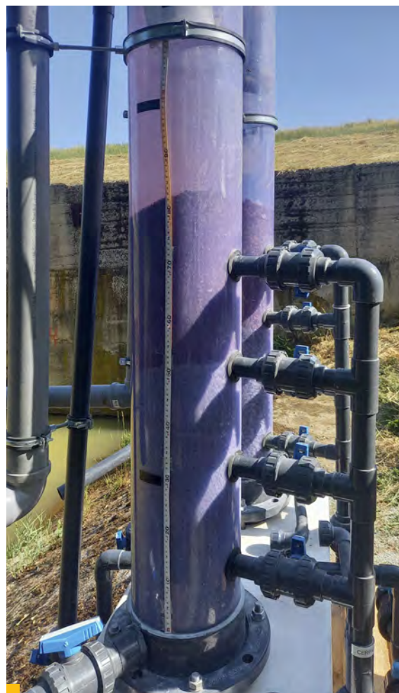
6 Odkalisko Poša – inštalovaná mobilná čistiaca jednotka so zeolitom
