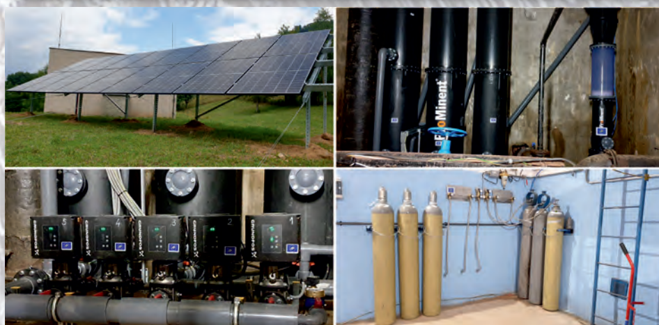
Rekarbonizačné zariadenie na obohacovanie pitnej vody (vodný zdroj Kokava nad Rimavicou, viac v príspevku Rapant a kol. v tomto zborníku, foto: V. Cvečková)
