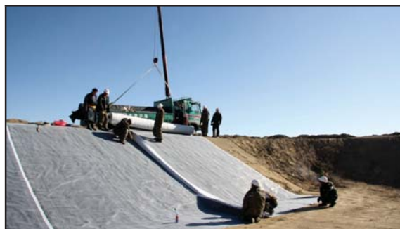
Obr. 4 Výstavba zabezpečené kazety v prostoru skládky komunálního odpadu v Morin Davaa - pokládka bentonitových rohoží
