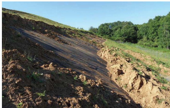
Obr. 1 Príklad porušenia svahov skládky (foto Frankovská, 2013)
