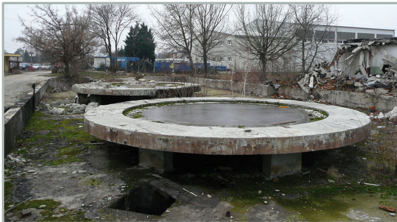
Nitra - Chrenová, mazutová kotolňa (pravdepodobná environmentálna záťaž)
